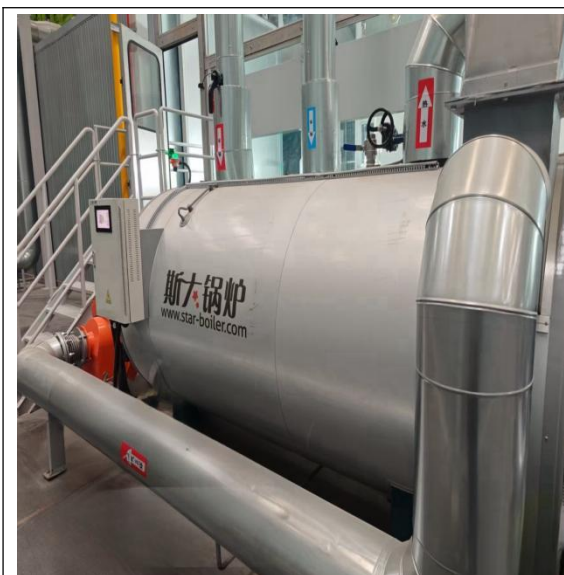
底架车间锅炉
